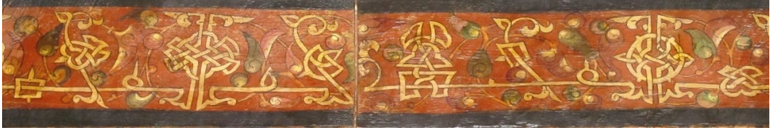
Fotoğraf 57: Bey Mahfilinde bulunan ahşap üzeri kalem işi bezemeler detay
