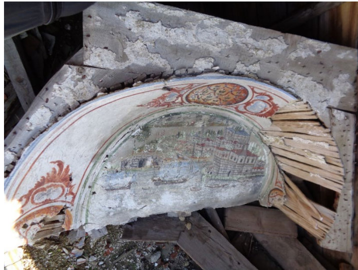
Resim 18 Köşk mekânında yer alan düşmüş vaziyette manzara resmi
