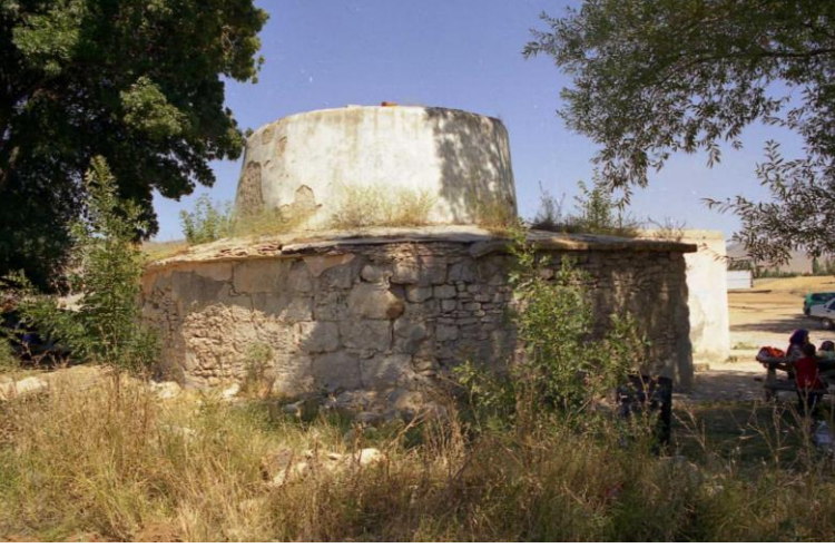
Kaplıcanın onarım öncesi durumu
